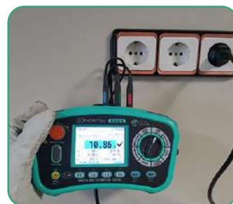
Pomiar impedancji pętli
